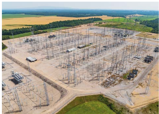
Poste électrique de la Jacques-Cartier, situé dans la Ville de Pont-Rouge (MRC de Portneuf)
