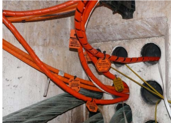
Identification des câbles de télécommunications sur une plaque.
