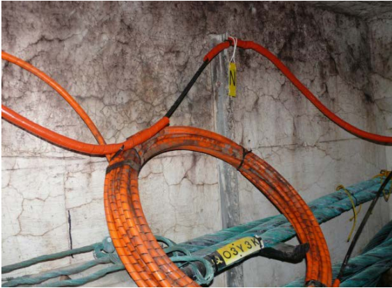
Boucle temporaire de câble de télécommunications directement sur les câbles électriques (à proscrire).
