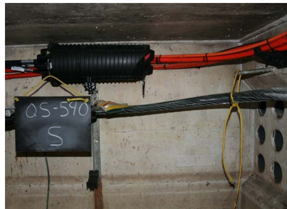
Boîtier de jonction situé à moins de 1000 mm du petit mur.
