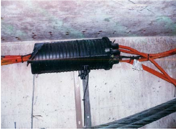
Boîtier de jonction cadenassé et fixé adéquatement sur le premier trou de la cornière.
