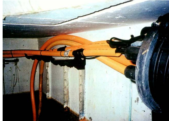
Utilisation de conduit flexible autour un câble de télécommunications (à proscrire).
