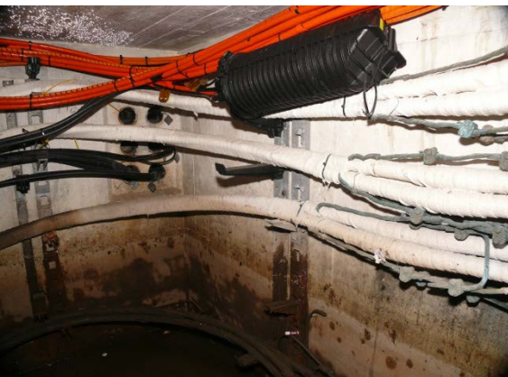
Boîtier de jonction directement par-dessus un joint électrique (à proscrire).
